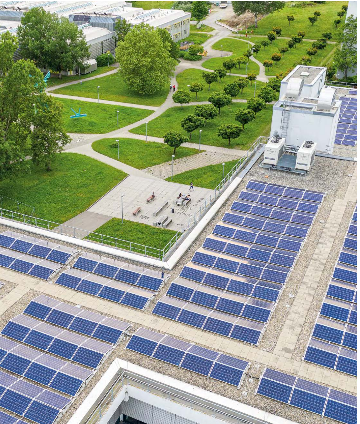
Bild: Photovoltaikanlage auf Dach (© Umweltministerium / Björn Hänssler)
