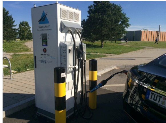
Abbildung 18 - Schnellladestation von Tank & Rast Quelle: Initiative Zukunftsmobilität
