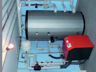
Heizungsanlage mit Wärmepumpe
